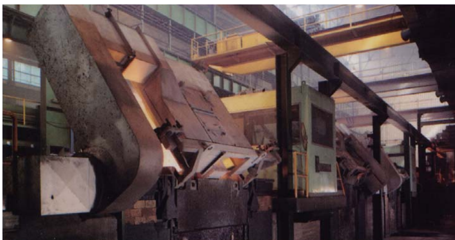
Smältutrustningen från Inductotherm med effekten 15 MW har två 20 tons smältugnar och styrsystemet Melt Minder 200®. Detta kommer att bli det största Dual-Trak-systemet som någonsin installerats.
